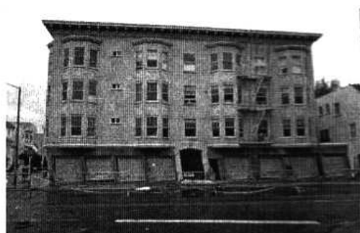
Figura 4. Daño sísmico en una configuración con el piso blando en el primer nivel. Las grandes aberturas generan grandes distorsiones en ese piso.
