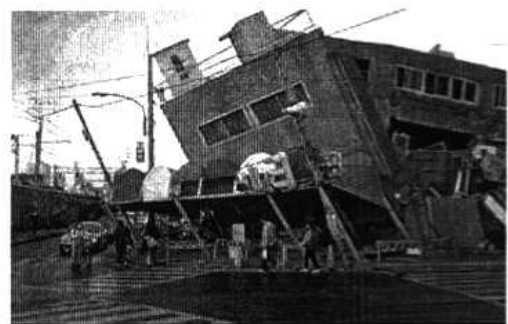
Figura 5. Colapso total producido por un sismo en una edificación de dos niveles con un primer piso blando.
